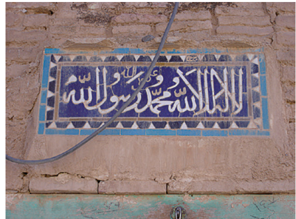
223. Bīdākhawīd, complexe de Bābā Shaykh 'Alī Bīdākhawīdī, mosquée. Détail de l'inscription surmontant la porte d'entrée (2009)
